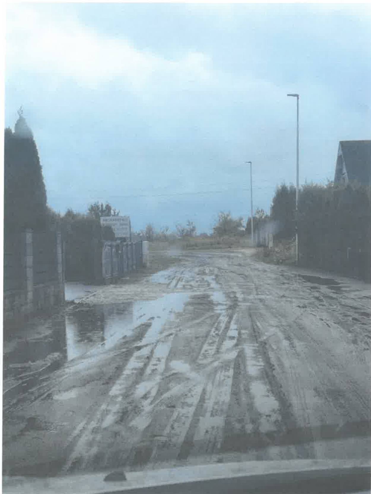
Załącznik nr 1- Dokumentacja fotograficzna stanu drogi z dnia 10.09.2024r.
