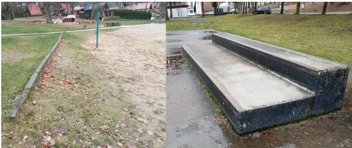
Ryc. 25. Zdegradowane elementy infrastruktury sportowej
